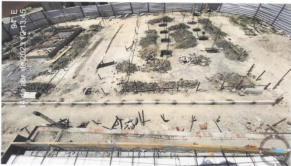
Foto 13 - (COMPOSIÇÃO REPRESENTATIVA) EXECUÇÃO DE ESTRUTURAS DE CONCRETO ARMADO, PARA EDIFICAÇÃO INSTITUCIONAL TÉRREA, FCK = 25 MPA. AF_01/2017.
