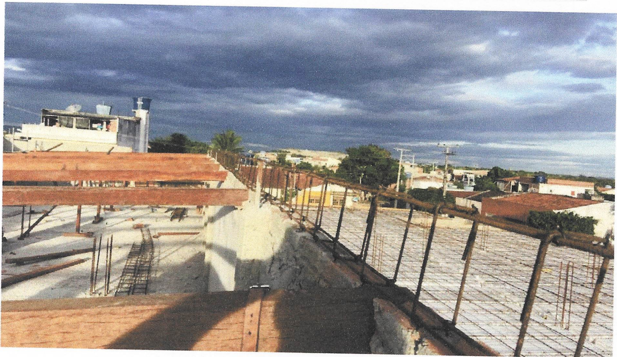
Foto 03- ARMAÇÃO DE PILAR OU VIGA DE UMA ESTRUTURA CONVENCIONAL DE CONCRETO ARMADO EM UM EDIFÍCIO DE MÚLTIPLOS PAVIMENTOS UTILIZANDO AÇO CA-60 DE 5,0 MM - MONTAGEM. AF_12/2015.
