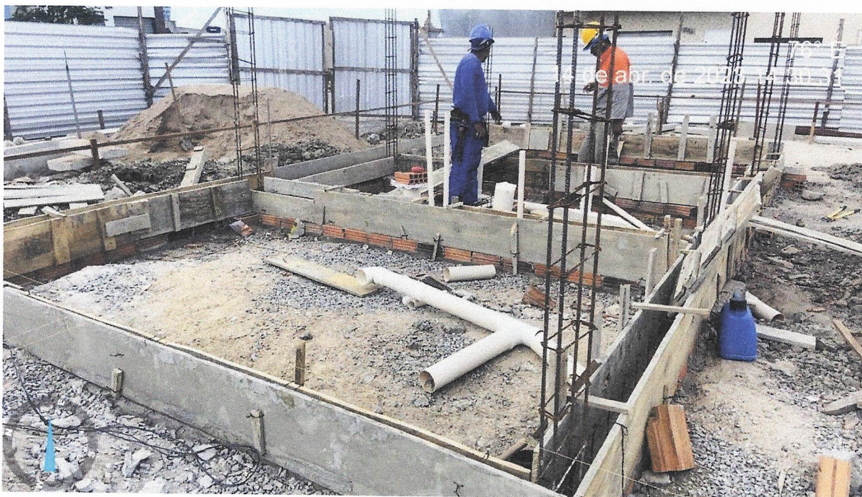
Foto 17- (COMPOSIÇÃO REPRESENTATIVA) EXECUÇÃO DE ESTRUTURAS DE CONCRETO ARMADO, PARA EDIFICAÇÃO INSTITUCIONAL TÉRREA, FCK = 25 MPA. AF_01/2017
