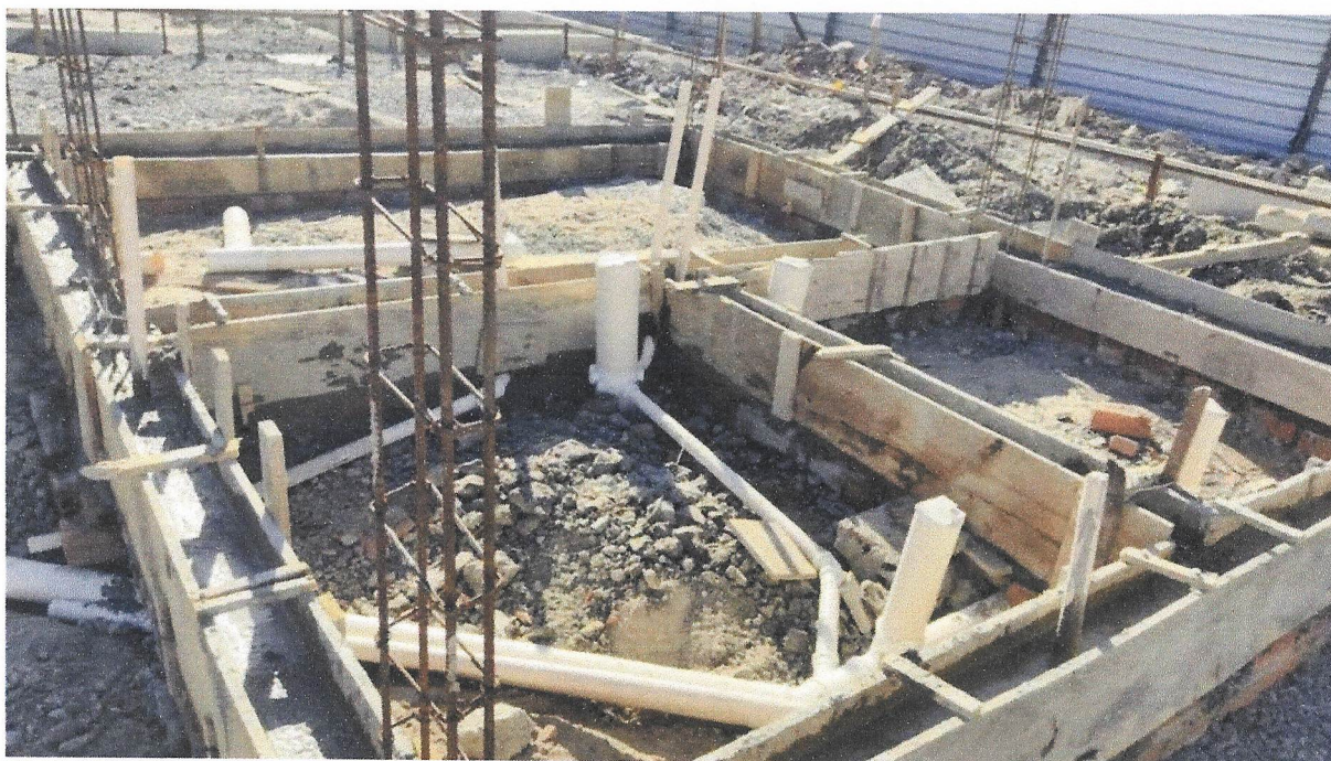
Fotos 20 - Ponto de esgoto com tubo de pvc rígido soldável de Ø 100 mm (vaso sanitário).
