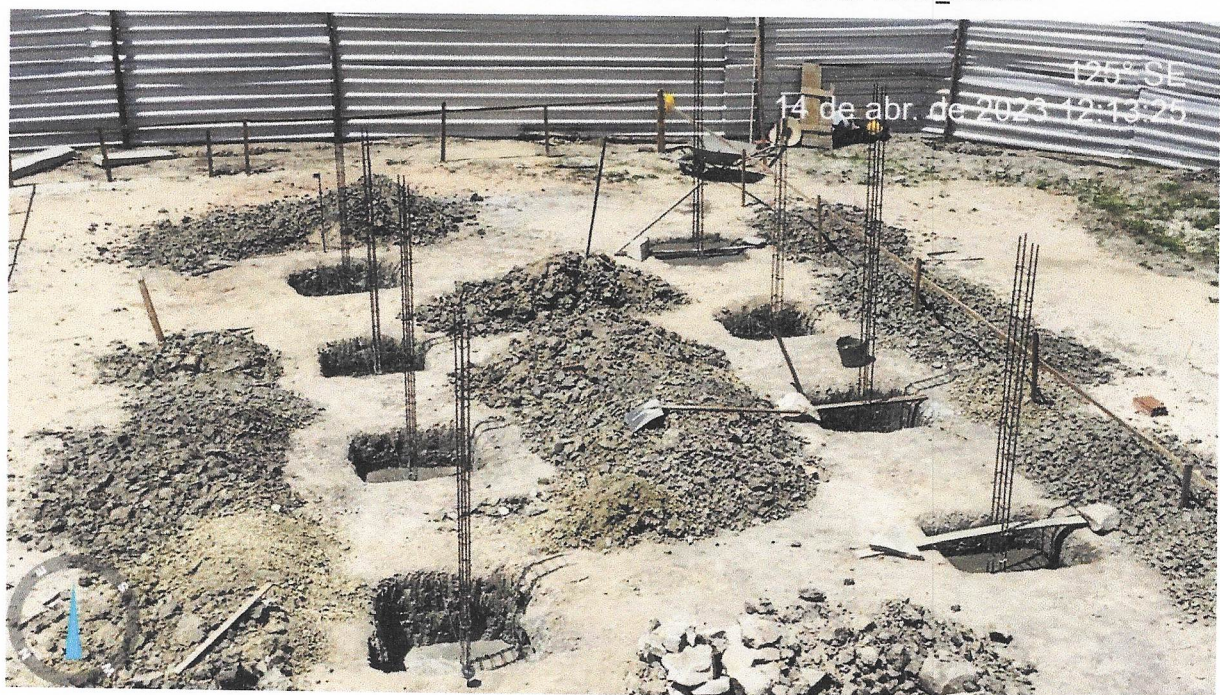
Foto 14 - (COMPOSIÇÃO REPRESENTATIVA) EXECUÇÃO DE ESTRUTURAS DE CONCRETO ARMADO, PARA EDIFICAÇÃO INSTITUCIONAL TÉRREA, FCK = 25 MPA. AF_01/2017
